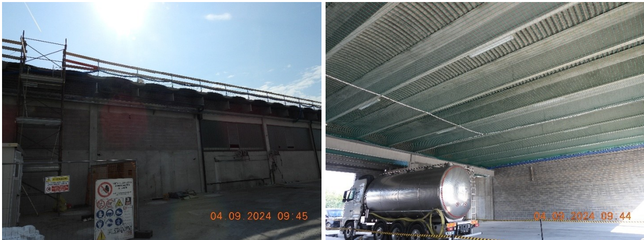
Figura 27 – Parapetti a protezione dei lati prospicienti al vuoto e rete di sicurezza anticaduta di tipo “sistema a S”.
